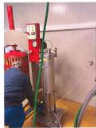
Filtrage des déchets
